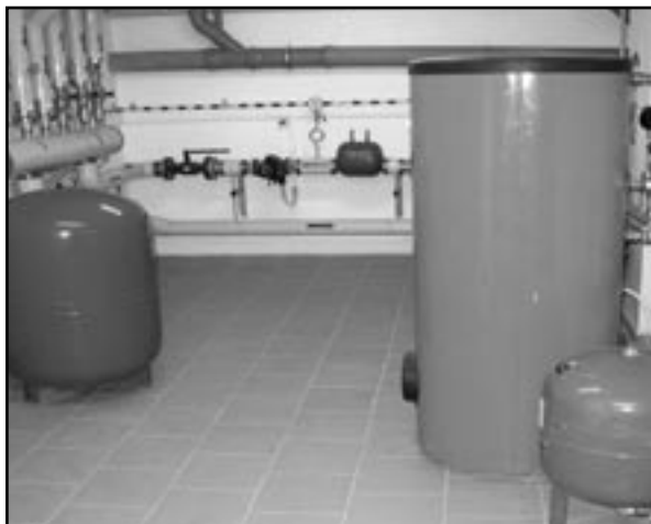
Nowa sala przy LO jest ogrzewana dzięki budowie wykonanej przez MPECWiK
