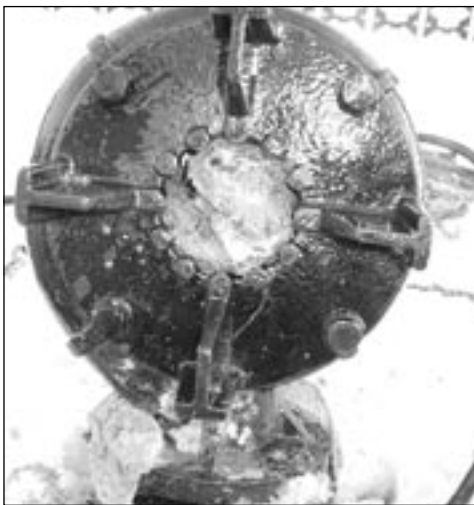
Takie śmieci spowodowały awarię kanalizacji w Koszutach
