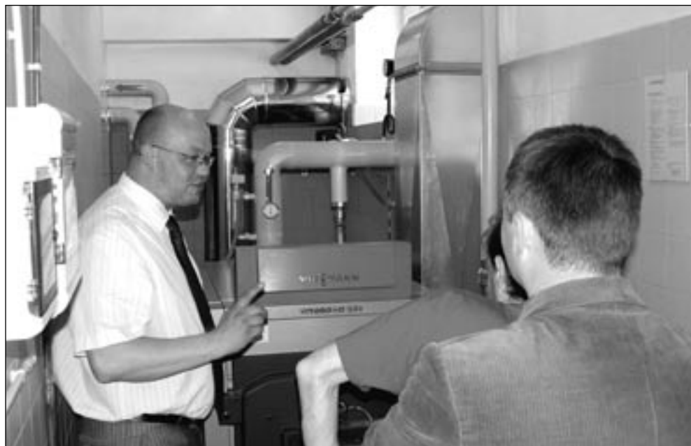
Kotłownia gazowa na Pływalni Miejskiej ogrzewa wodę oraz wszystkie pomieszczenia na basenie
