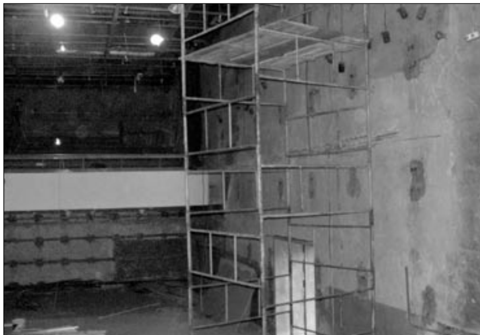
Obecnie sala widowiskowa „straszy” zerwanymi sufitami czy zdemontowanymi fotelami balkonowymi. Nowe oblicze tego miejsca ujrzymy około połowy października.
