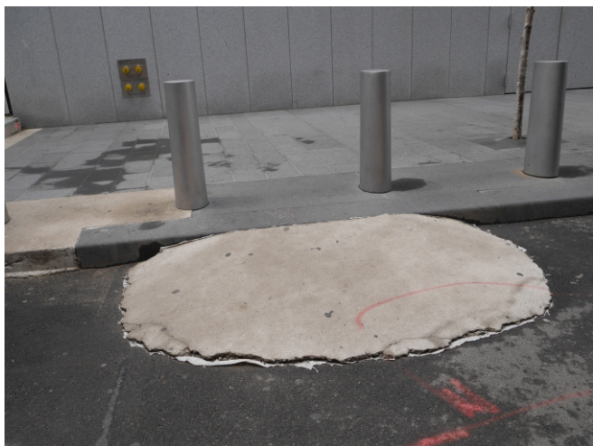
Ryc. 10.2. Na obejściach należy umożliwić zjazd z chodnika poprzez wykonanie tymczasowych pochylni (autor: M. Wysocki).
