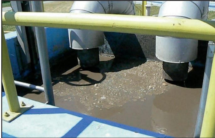
Oto komora rozdzielcza
