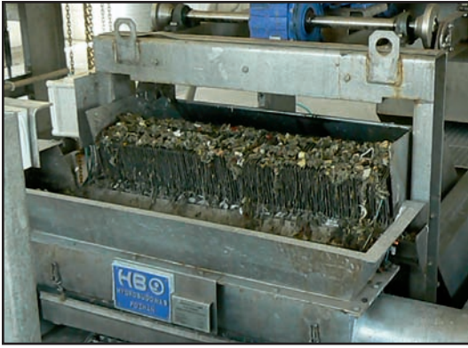
Kraty gęste. Tu odbywa się pierwszy etap mechanicznego oczyszczania surowych ścieków z części stałych
