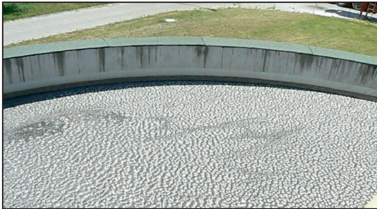
Chemicznie zmodyfikowane ścieki trafiają do zagęszczacza grawitacyjnego, gdzie wstępnie odwadnia się osad
