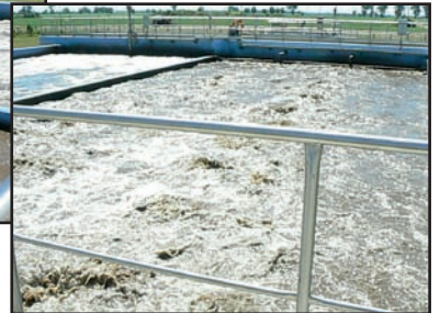
tu też pracują bakterie, stanowiące osad biologicznie czynny
