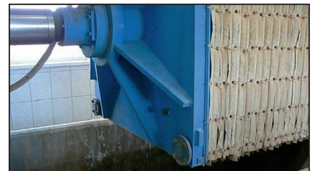
Etap ostatni to komora do ostatecznego odwadniania osadu. Tu wyciska się resztę wody z osadu pościekowego, po dodaniu wapna i innych środków chemicznych
